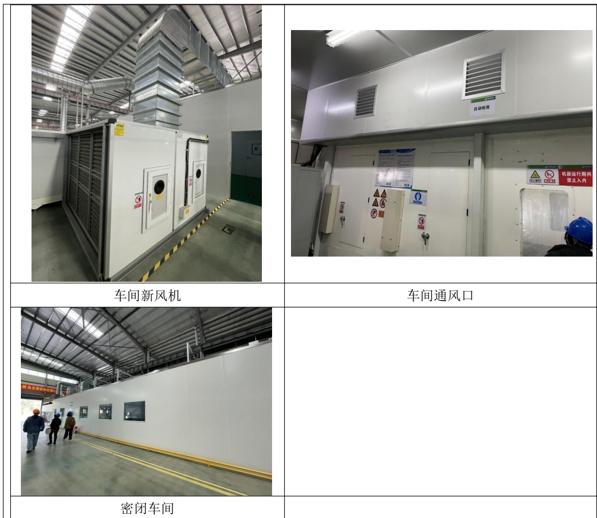
图3.2-1 废气处理措施
